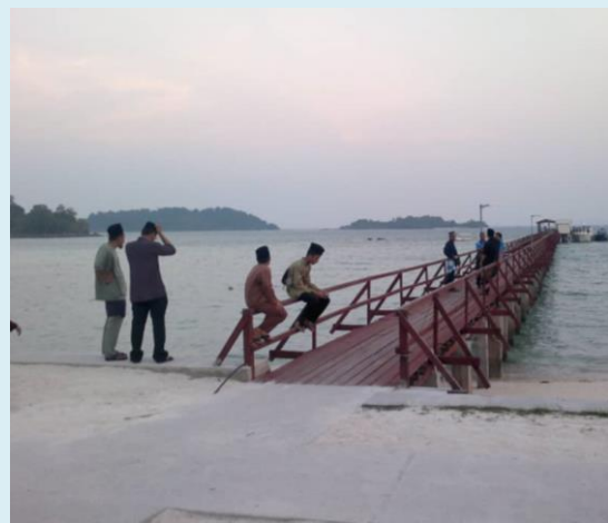
Foto: Keadaan Semasa Jeti Kayu Pulau Tinggi
