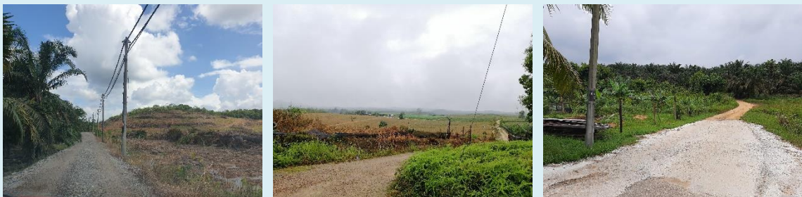
Foto: Antara keadaan struktur jalan raya yang tidak berturap bagi kawasan pertanian
